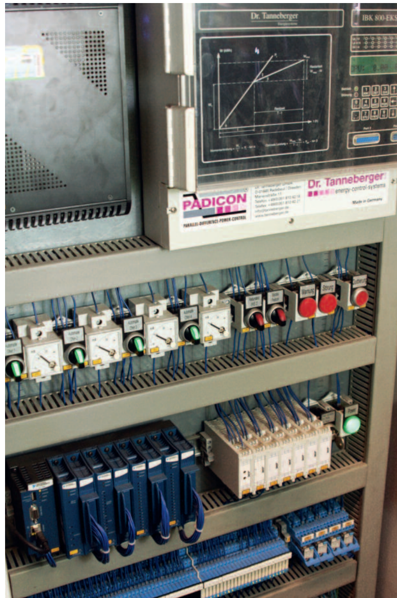
Seit August 2008 verfügt die Walzengießerei Coswig GmbH über ein Energie-Management-System mit Parallel-Differenzstrom-Regelung der Dr. Tanneberger GmbH. (Quelle: zzdd.de)
