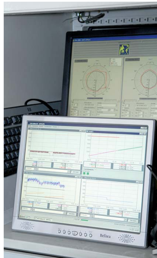
Bild 7: Alle nötigen Informationen erhalten die Mitarbeiter vor Ort: zwei Monitore zeigen den sekundengenauen Verlauf des Strombedarfs.
